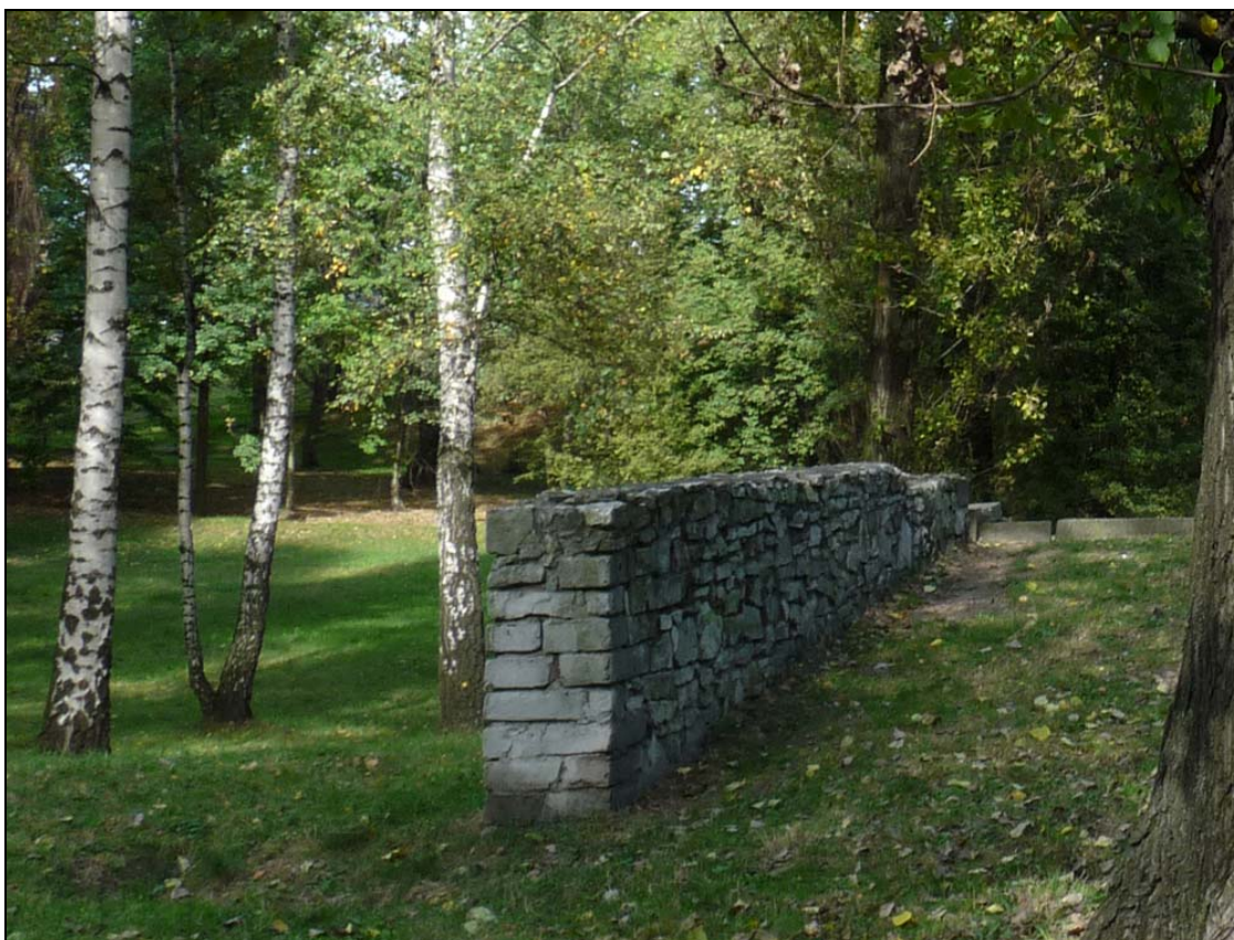
Fot. 16 Zachodnia ściana amfiteatru (widok ściany od wnętrza). Mur zachodni w stanie dobrym.
