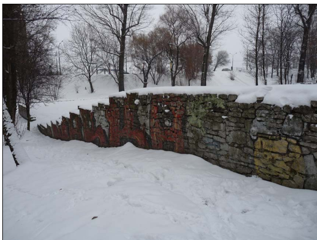
Fot.6 Amfiteatr - ściana wschodnia / wschodnie skrzydło widowni (styczeń 2013). Widoczne od zewnątrz graffiti do usunięcia.
