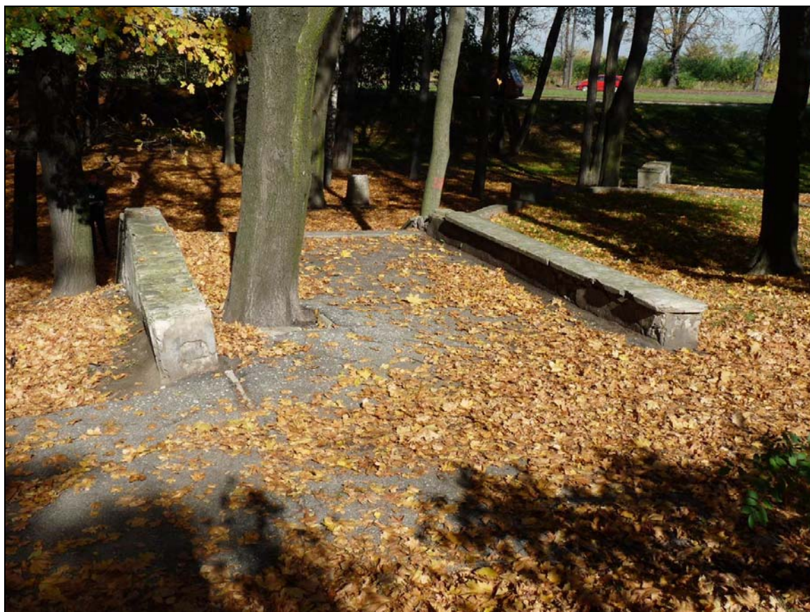
Fot.10 Schody D - na pierwszym planie drzewo rosnące u góry schodów (wrzesień 2012).
