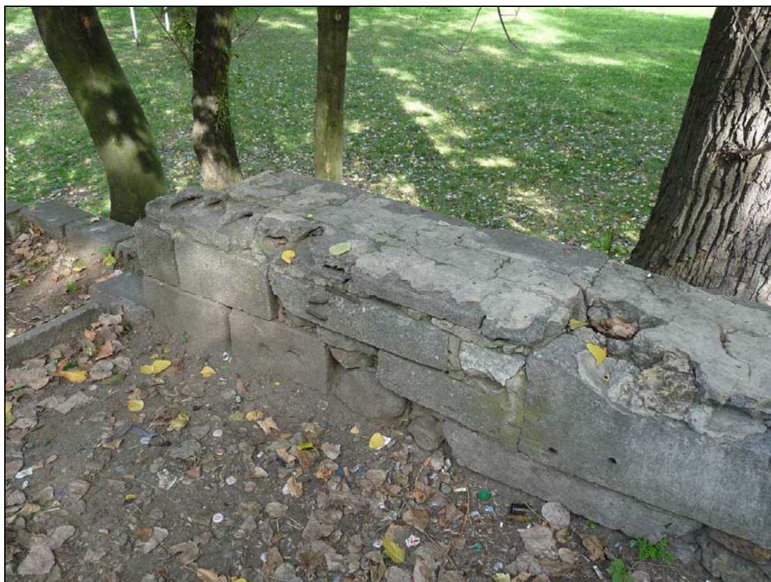
Fot. 17 Wschodnia ściana amfiteatru - w bardzo złym stanie technicznym. Mur wschodni w stanie złym.
